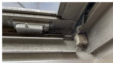
レールの汚れ
